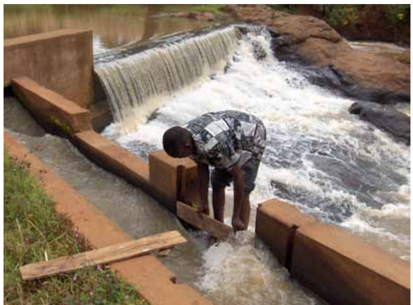
一小型水电站开启进水闸门。
